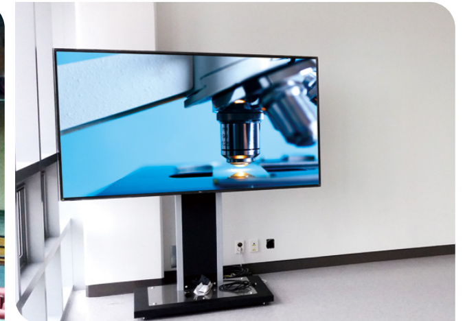
강의실 비대면수업 대형모니터 설치
